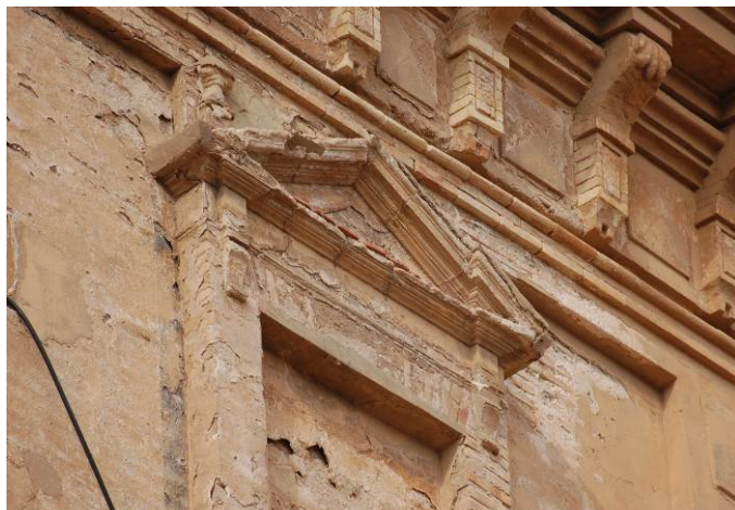
Detalles de muros fracturados y recubrimientos descompuestos.
