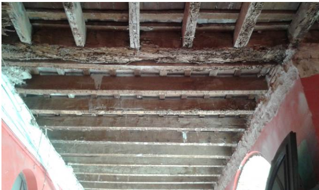
Elementos de madera podridos y afectados por xilófagos que precisaban sustitución y respuestas constructivas.
