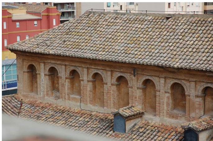
Volumen "Coloseo" en ladrillo con huecos tabicados y muros en mal estado por el envejecimiento de sus materiales.
